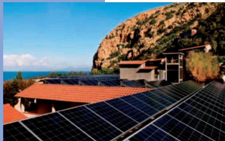
Impianto fotovoltaico da 51 kWp
