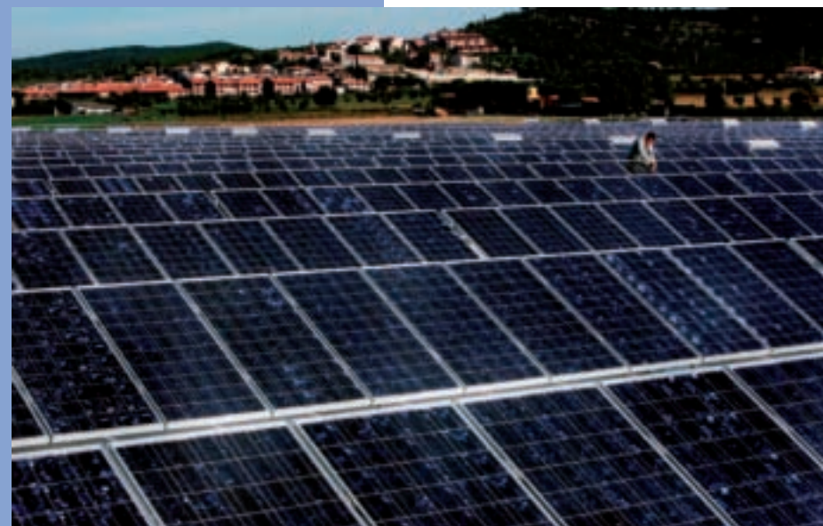
Impianto fotovoltaico da 420 kWp
