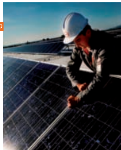
Impianto fotovoltaico da 420 kWp
