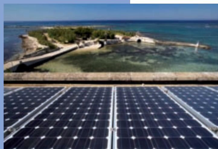
Impianto fotovoltaico da 20 kWp
